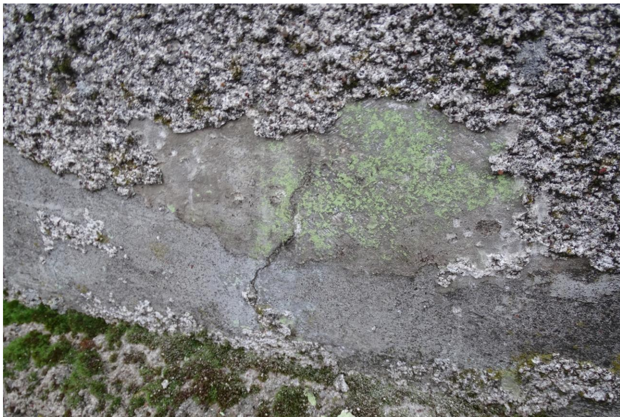
Fot. Waldemar Brzostek grudzień 2024 r. (widok nawarstwień wtórnych- „baranek”)
