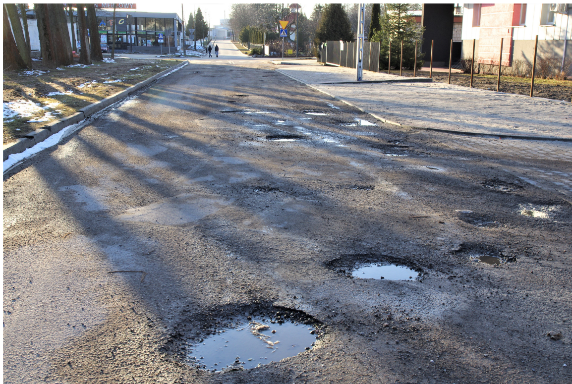
Ul. Komunalna. Wyboje, ubytki w nawierzchni bitumicznej.
