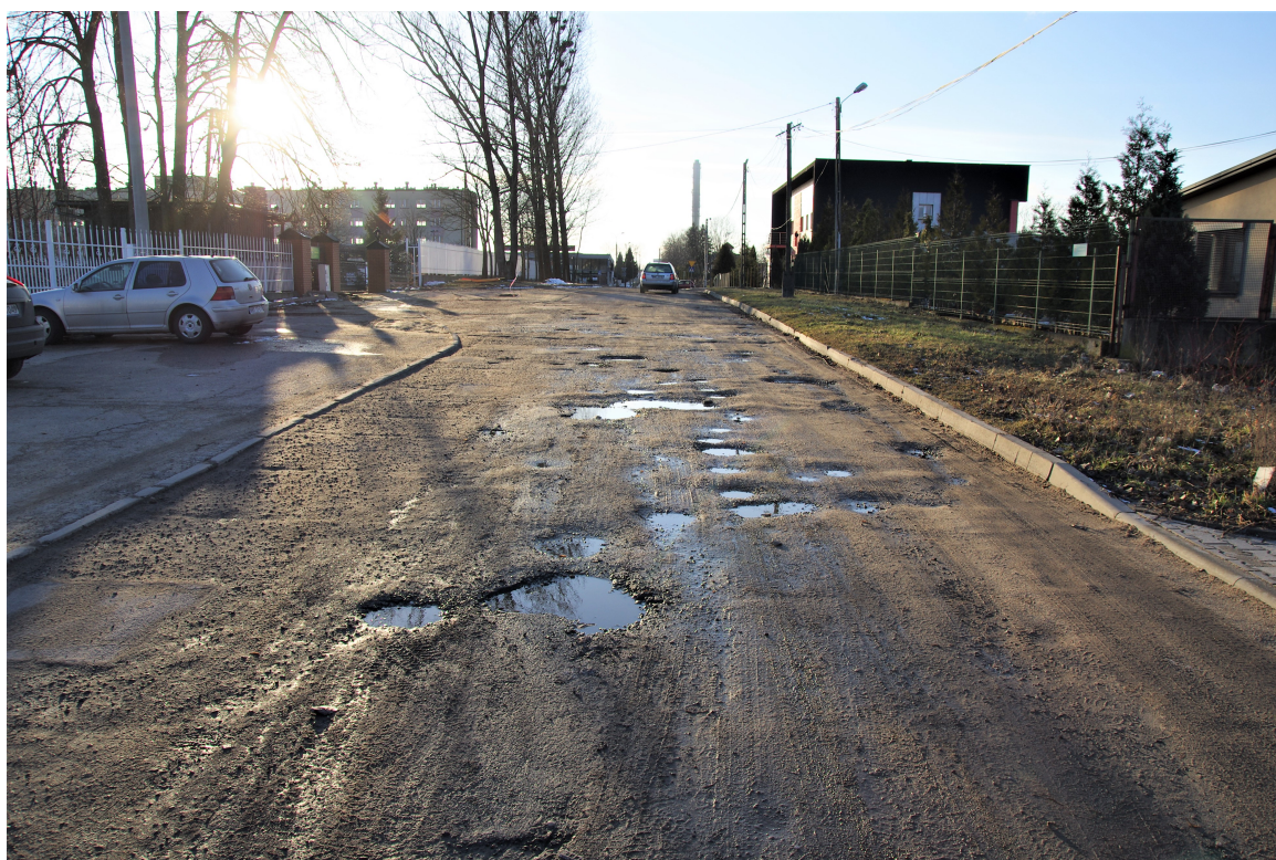
Ul. Komunalna. Wyboje, ubytki w nawierzchni bitumicznej.
