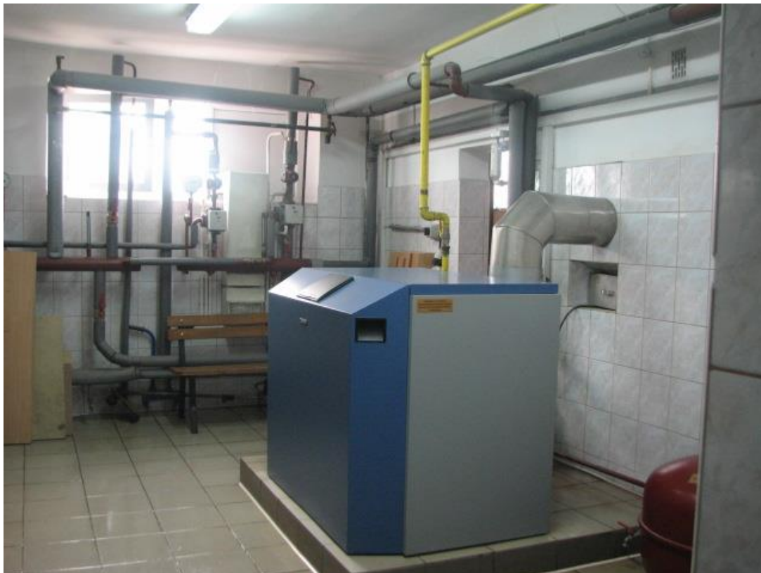
fot. nr 4: kotłownia
