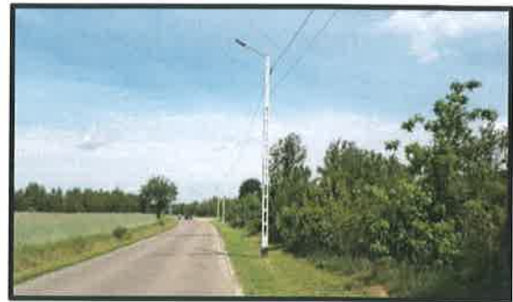
Linia oświetlenia ulicznego w Leszczydole Starym
