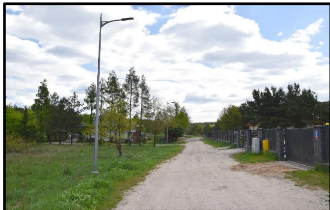
Linia oświetlenia ulicznego przy ul. Dobrej w Drogoszewie
